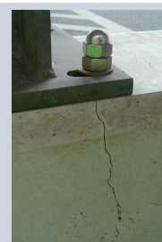
■コンクリート割れ
